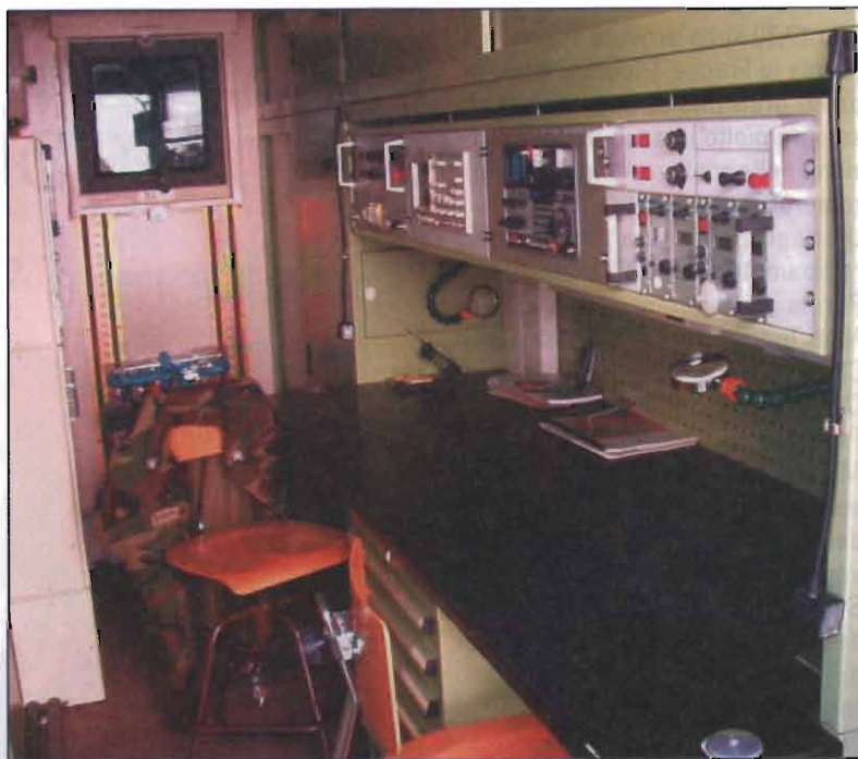
Interno shelter manutenzione apparecchiature radio
