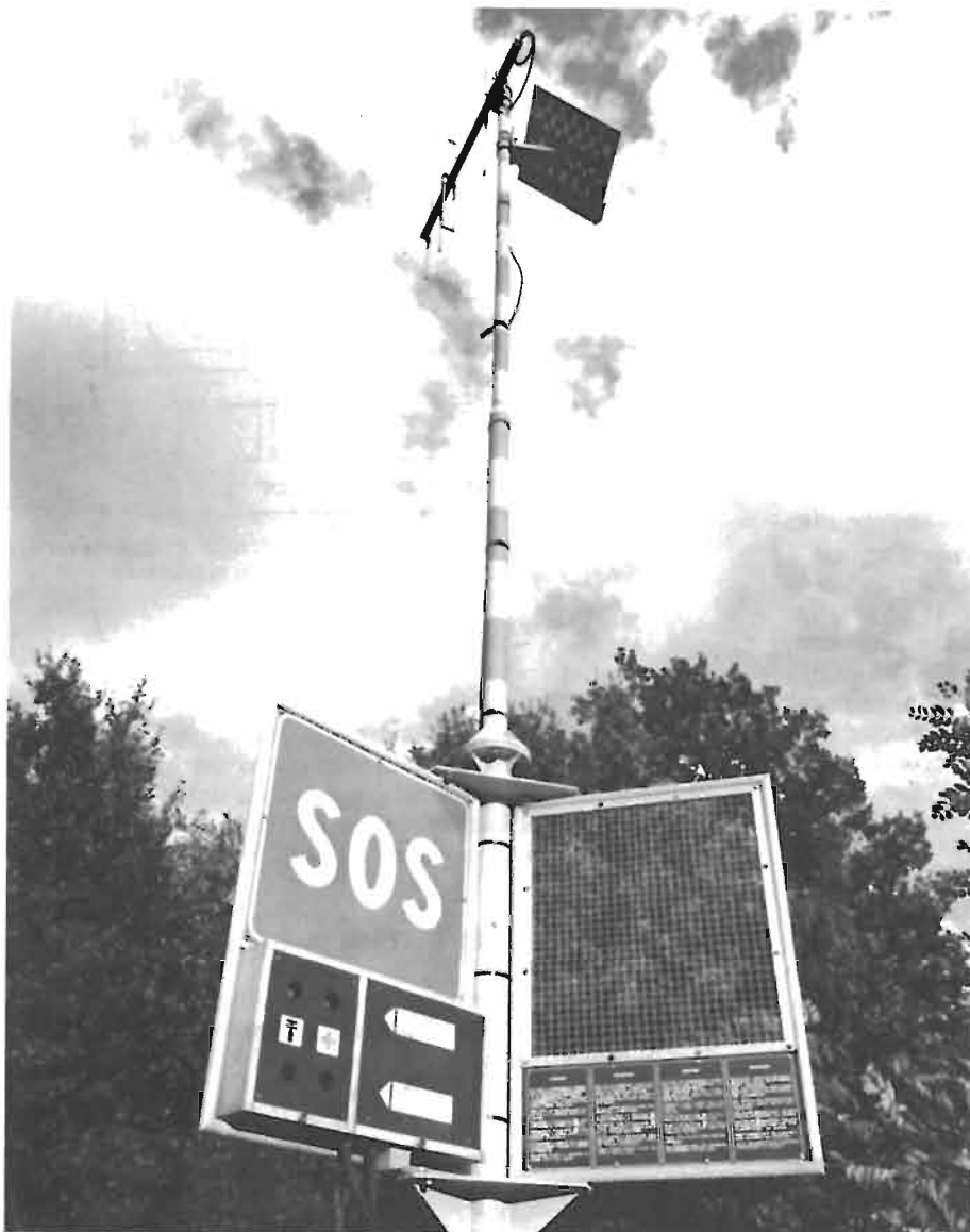
Esempio di piccolo impianto a pannelli solari impiegato per l'alimentazione delle apparecchiature di una colonnina di soccorso lungo l'autostrada Roma-L'Aquila. (Impianto realizzato dalla Divisione Telecomunicazioni della Philips S.p.A.)
