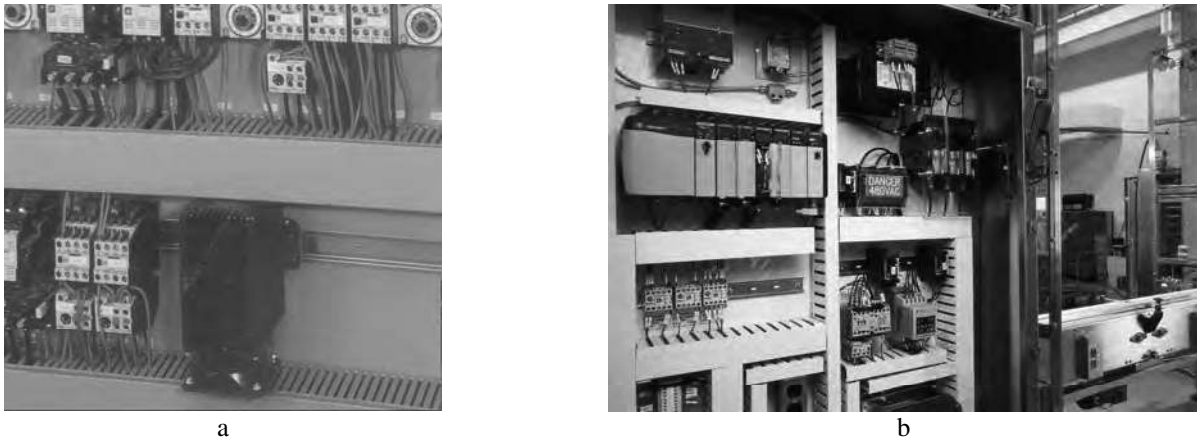
Fig. 6.351 - a) Esempio di installazione di una resistenza anticondensa in un quadro elettrico - b) Quadro elettrico con PLC.
