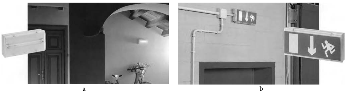
Fig. 2.164 - Illuminazione di emergenza: a) Esempio di applicazione di un apparecchio di illuminazione di riserva - b) Esempio di applicazione di un apparecchio di illuminazione di sicurezza (Gewiss).
