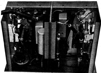
Fig. 8. — Vue du câblage de l'appareil. On constate encore la présence de la réparation.
