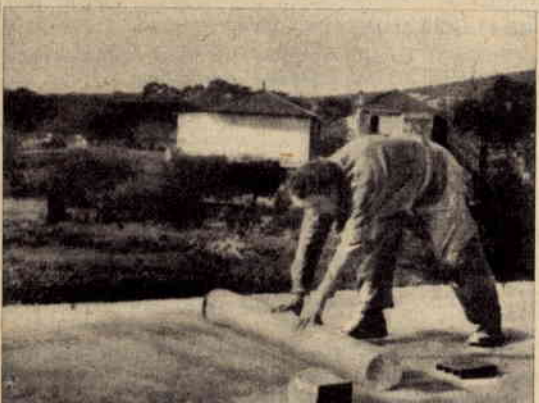
Fig. 2 - Steso uno strato di sabbia fine, srotoleremo il foglio di polyetilene, iniziando dalla parte di livello più basso della terrazza...
