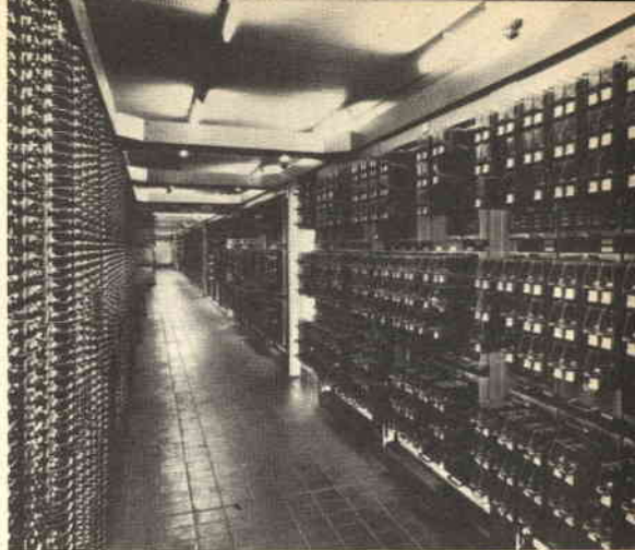
Fig. 4 - Tipica sala di relé impiegante un'attrezzatura che è stata realizzata dalla AEI - General Signal.
