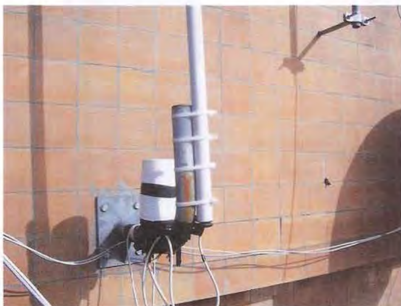
Fig.6 Ecco come abbiamo risolto il problema del fissaggio del tubo contenente l'amplificatore.
