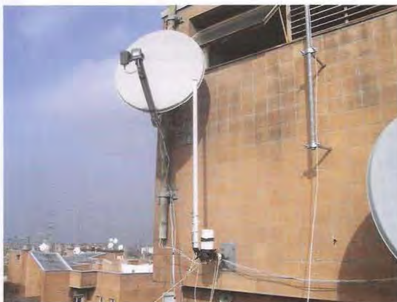
Fig.5 L'antenna montata sul tetto del palazzo in cui è ubicata la sede di Nuova Elettronica.
