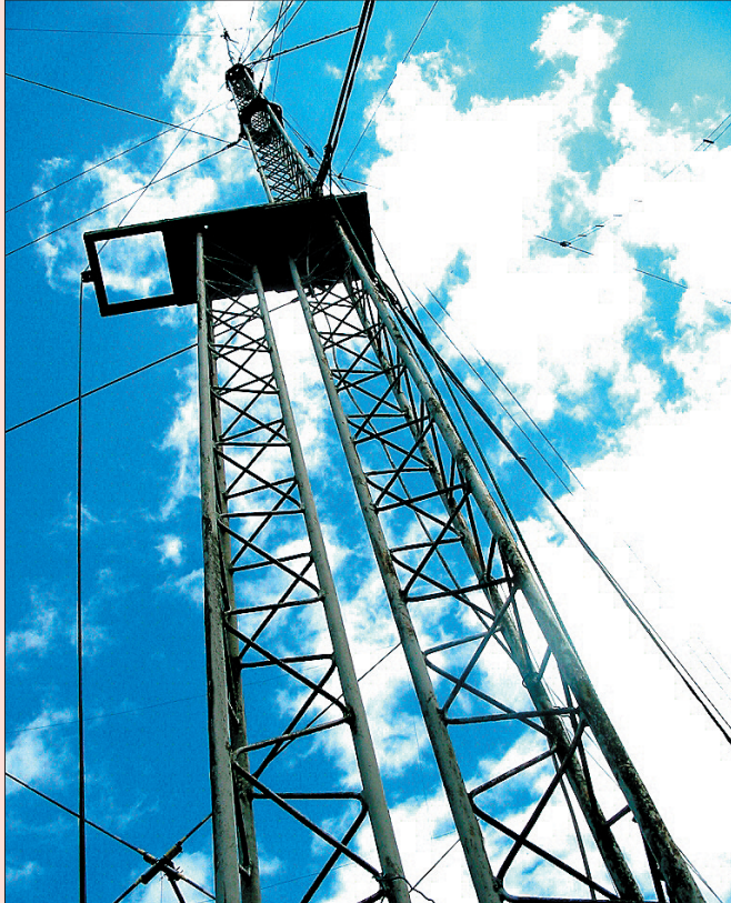
2 - La solution retenue chez F5MPW : un pylône à la base prolongé ensuite par un mât jusqu'à 17 m.
