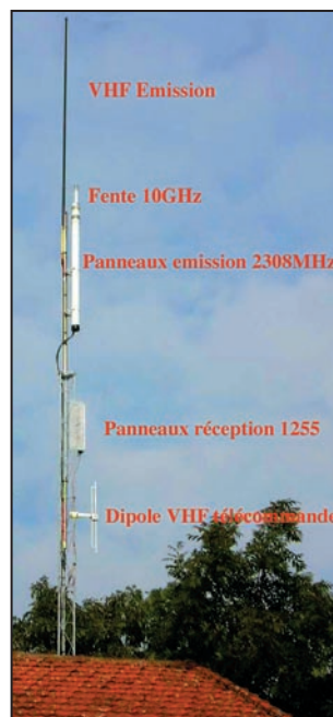
3 - Filtres réjecteurs pour les antennes.
