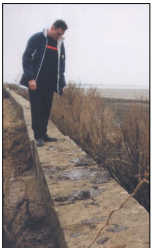
Constatation des dégâts par F5NZN.
