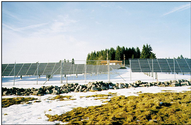
La photo du champ de panneaux solaires Mt Soleil.
