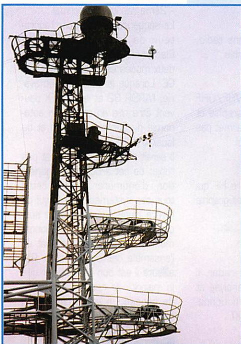
Pylône contre-mesures radar.
