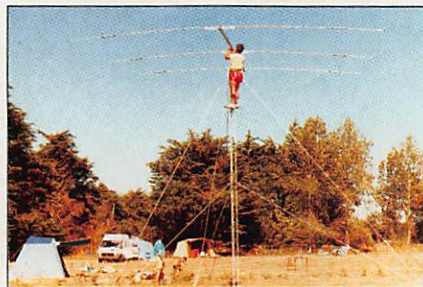
Installation des aériens décimétrique
