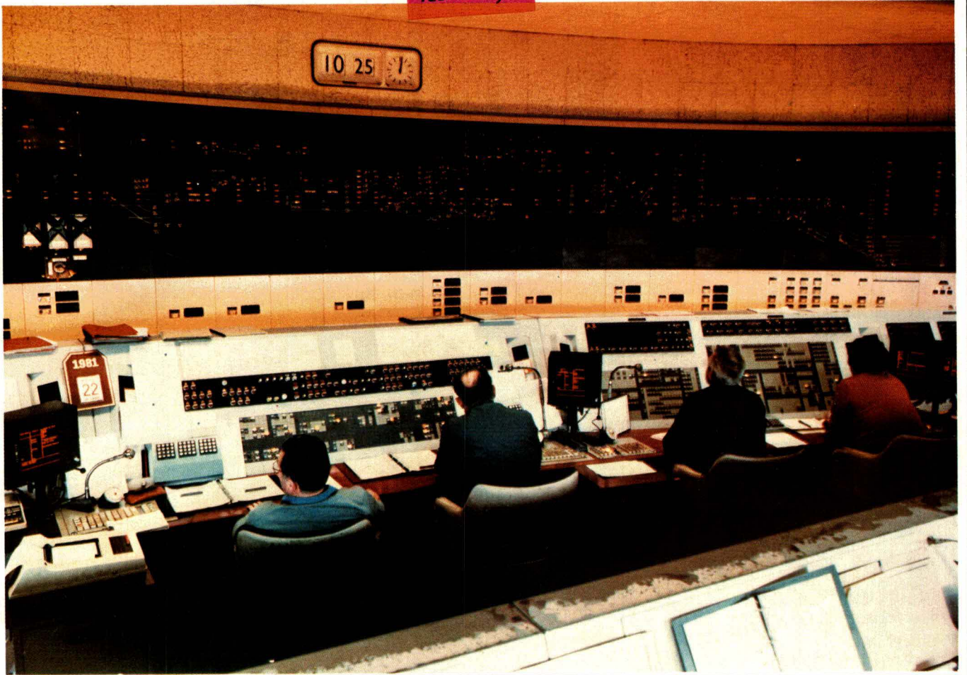
Fig. 10. – Panneaux à plasma dans un poste d'aiguillage de la gare d'Austerlitz à Paris (doc. Thomson-CSF).
