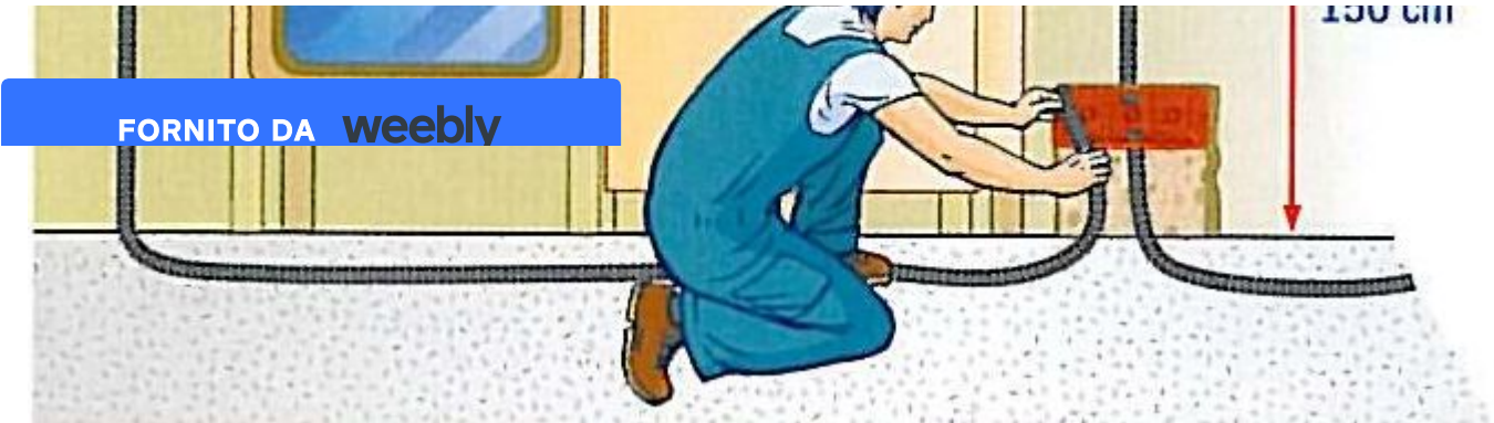
2. Predisposizione dei tubi e delle scatole per impianto di rilevazione gas metano e monossido di carbonio in cucina
