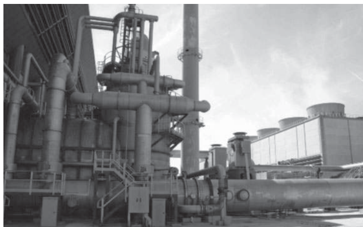
FIGURA 29 Centrale geotermoelettrica di Valle Secolo (PI).
